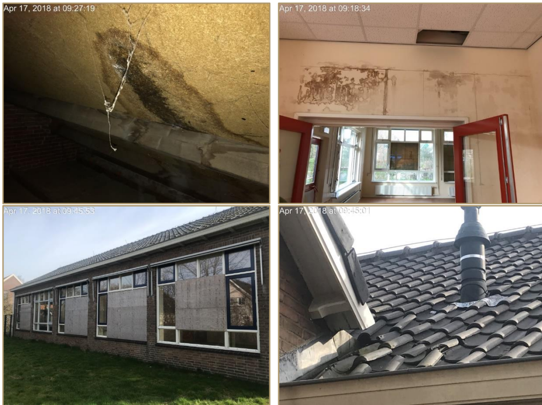
Foto's van inpandige waterschade, kapotte ramen en scheef liggende dakpannen
